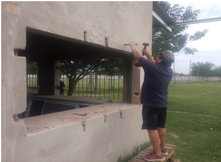
Construcción de salón de usos múltiples en la Asociación Deportiva y Social Loyola
